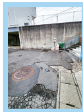
◀ 丸田町地域 漏水による凍結の危険があった道路通学路を修繕整備し、安全性を確保
